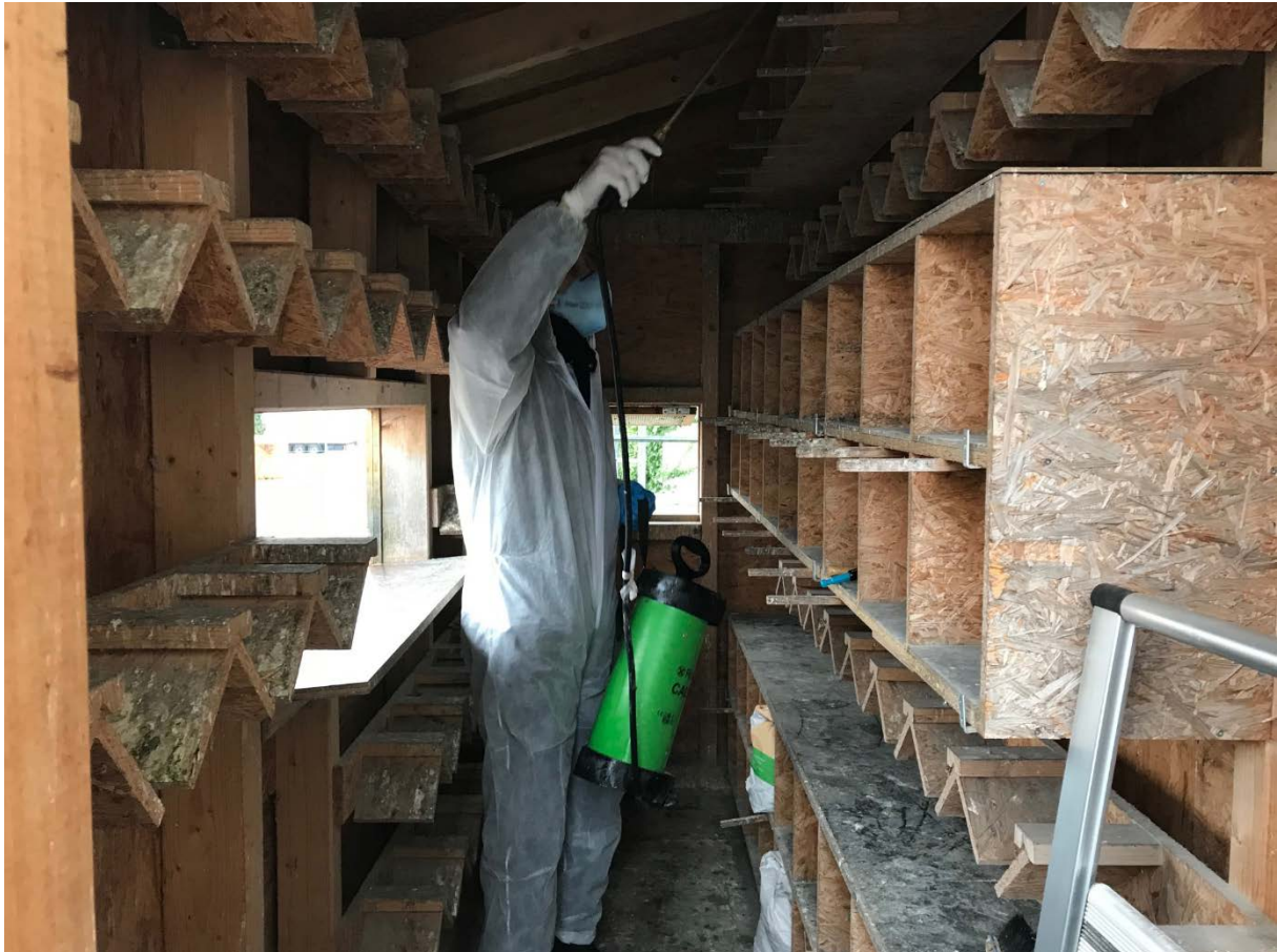
Chemische Desinfektion (mit Schutzkleidung)
